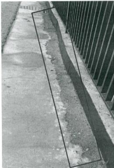
Imagen 5: Zona Perimetral desprendida.
