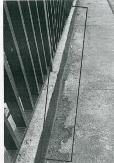
Imagen 6: Zona Perimetral desprendida.
